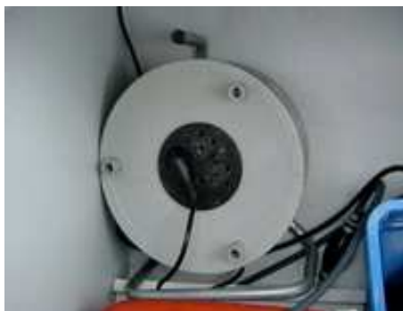
Landanschluß über Kabeltrommel
