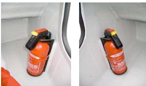
Feuerlöscher Backbord und Steuerbord Backskiste
