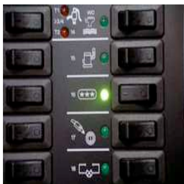
Kühlschrank – Schalter 12V-Paneel
