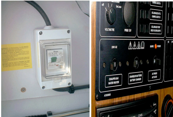
220-Volt FI – Backskiste Schalter Warmwasser
