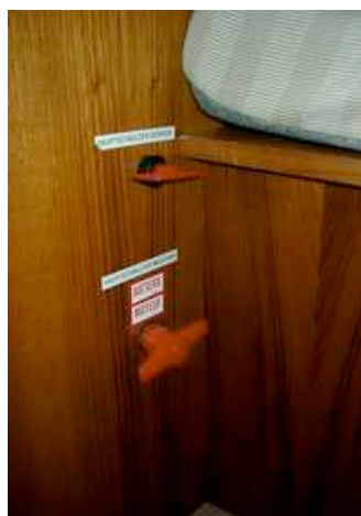
12-Volt Hauptschalter (Service – Maschine)
