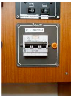
220-Volt Panel / FI
