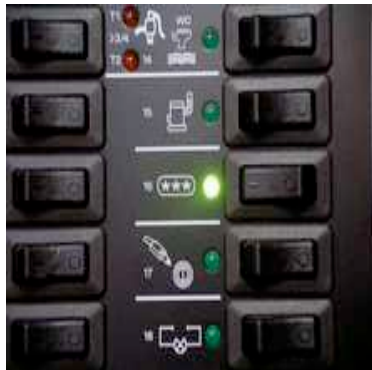
Kühlschrank – Schalter 12V-Paneel
